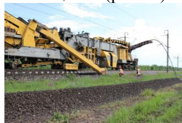
б – работа щебнеочистительной машины на перегоне с очисткой щебня и выбросом засорителей на полосу отвода
