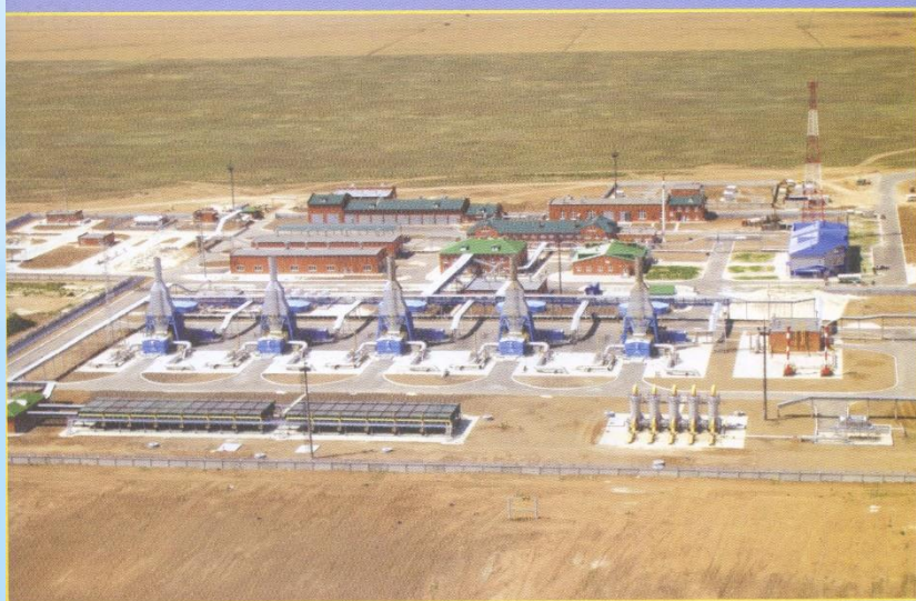
Общий вид компрессорной станции
